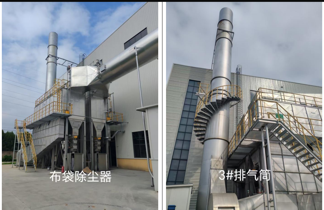
图 3-1 布袋除尘器+21m 高 DA003 排口
