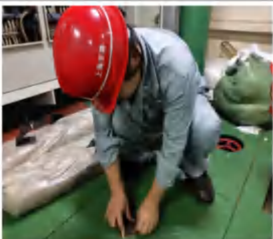
锚机接触器触头检查研磨
