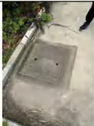
图 2.2-6 预制场生活区化粪池
