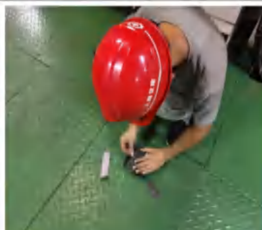
锚机接触器触头检查研磨
