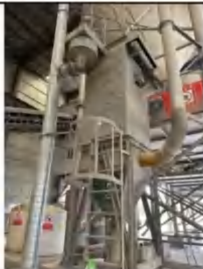
图 2.2-5 预制场搅拌站除尘器
