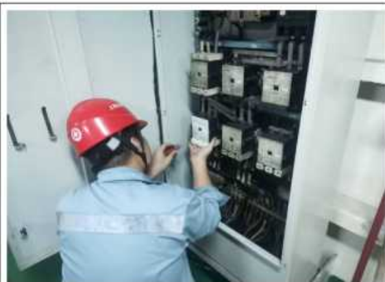
锚机接触器触头检查研磨
