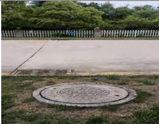
一期雨水排口
