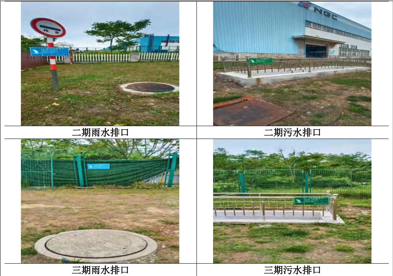
图 3-1 废水治理设施照片
