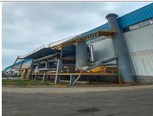
喷漆、烘干废气排气筒
