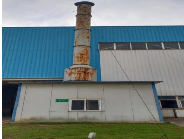
三期抛丸废气排气筒
