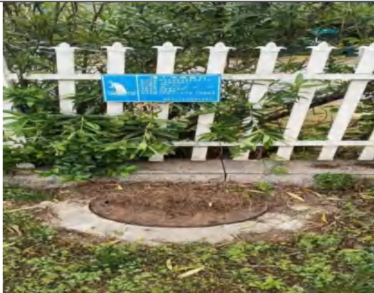
一期雨水排口
