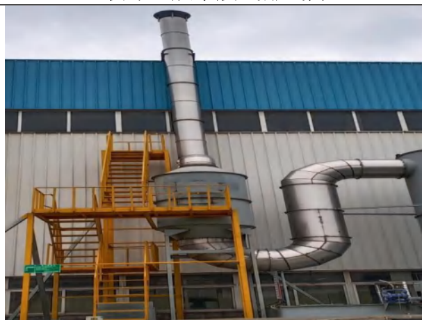
热处理废气排气筒
