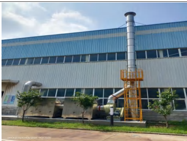
清洗房废气排气筒
