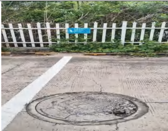
二期雨水排口
